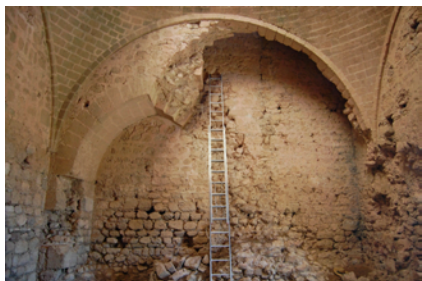
Figura 8. Cara este del interior de la torre. Se observa el derrumbe que se ha producido en el muro de escalera, llevándose consigo la mayoría de ésta y parte de la hornacina de arco apuntado. Foto del autor
