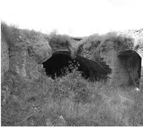
Figura 12. Vista del patio interior del baluarte con la bóveda de su casamata parcialmente hundida.
