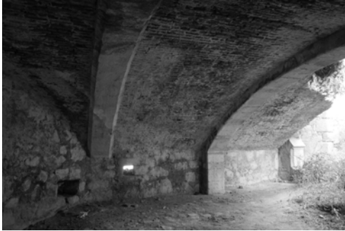
Figura 13. Vista interior de la casamata del baluarte con la bóveda de ladrillo reforzada con arcos fajones de cantería.
